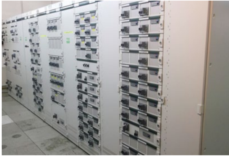
Die Schaltanlagen für die beiden Mülllinien wurden in diesem Jahr auf den neuesten Stand gebracht.
