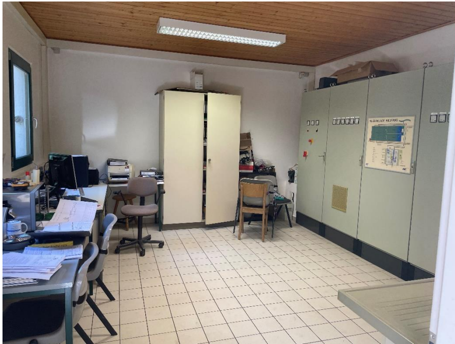
Abbildung 2-5: Schaltwarte mit Labor
