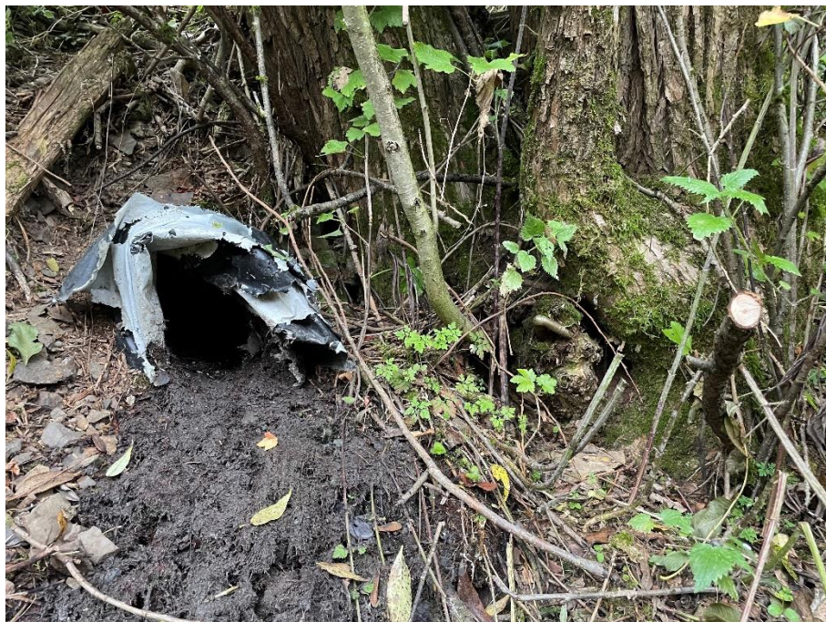
Abbildung 3-8: Einleitungsstelle 10 in den namenlosen Bach (Grund)
