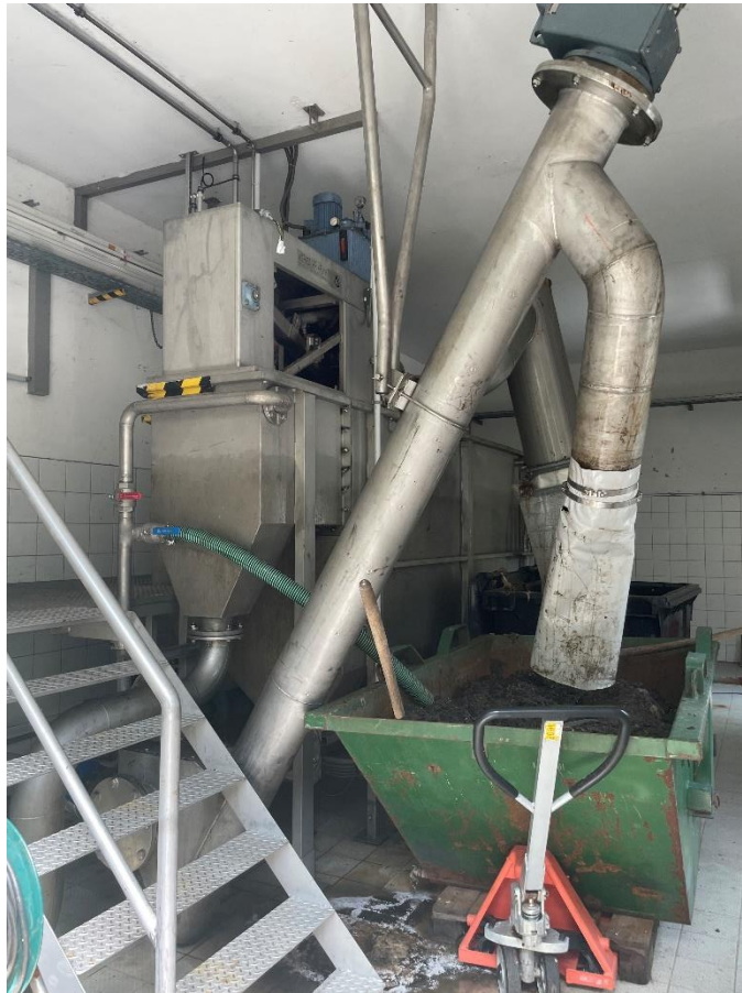
Abbildung 2-3: Rechenanlage im Betriebsgebäude
