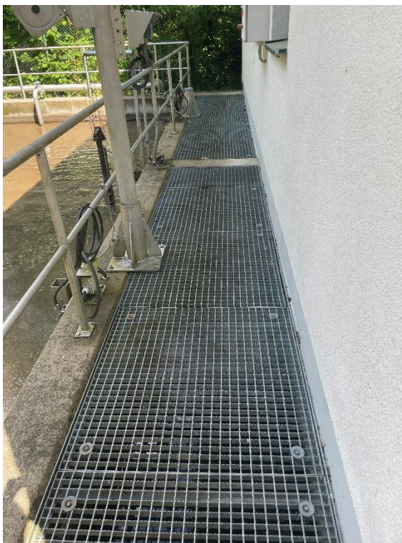
Abbildung 2-9: SU-Becken unter Gitterrostabdeckung und Betriebsgebäude
