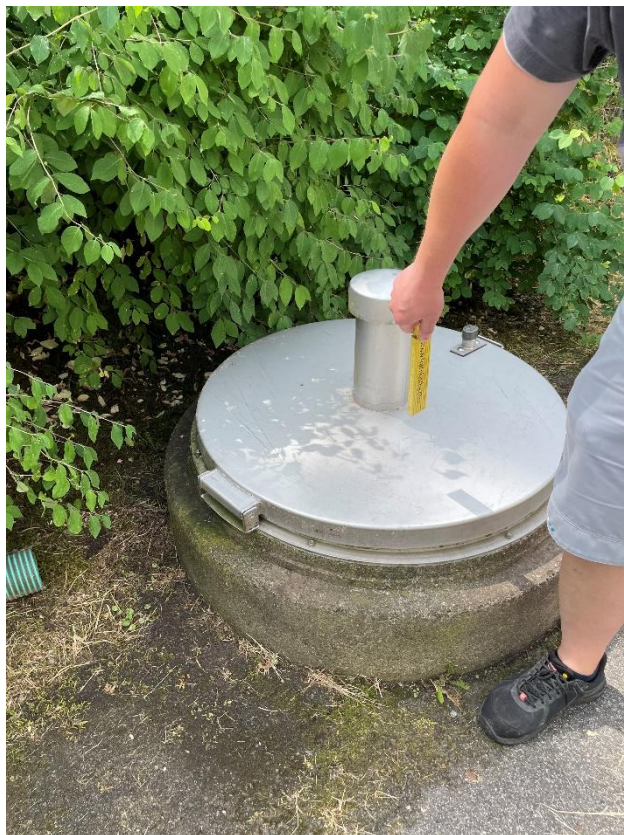
Abbildung 2-7: Revisionsschacht vor Betriebsgebäude
