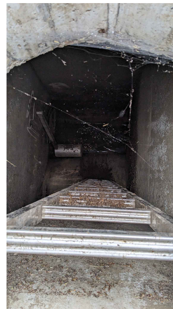
Drosselschacht mit Hydroslide
