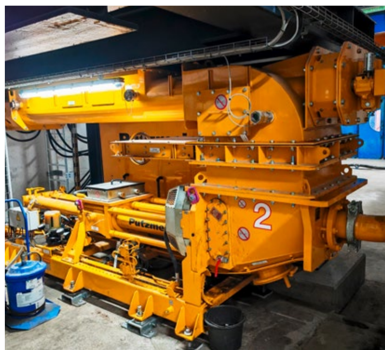
Austragsschnecke und Dickstoffpumpe unter Klärschlamm-Speichersilo
