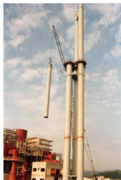
Nach zweijähriger Bauzeit wurde das MHKW Coburg 1989 in Betrieb genommen.
