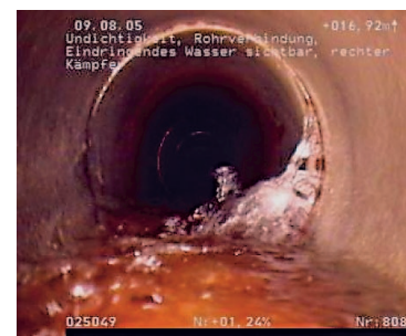
Fremdwasser im Kanal
