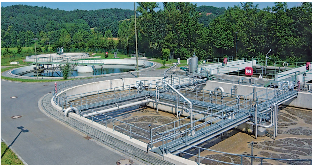
Belebungsanlage in Roding (25.000 EW Ausbaugröße)
