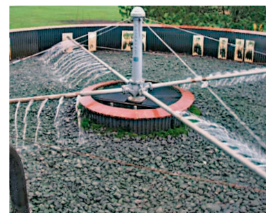
Tropfkörper der Kläranlage Horgau (4.500 EW Ausbaugröße)
