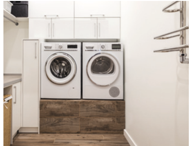
Waschmaschine und Trockner auf einem Podest
