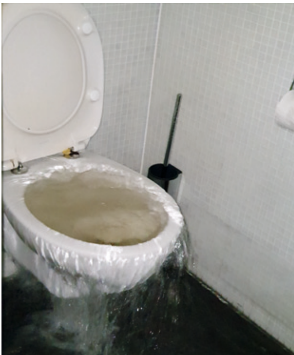
Sanitärgegenstände sollten nach einem Überflutungseignis aus hygienischen Gründen ausgetauscht werden.
