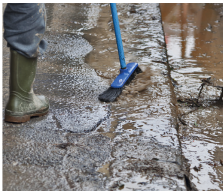
Schlammabreinigung mit abfließendem Hochwasser
