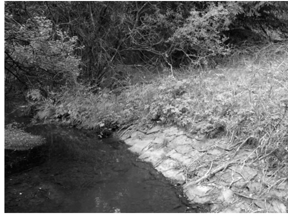
Im Kurvenbereich ist durch die Kraft des Wassers die Pflasterung vegetationslos und daher deutlich zu sehen.
